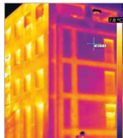
Изображение того же здания, полученное с помощью инфракрасной камеры (тепловизора), позволяет наглядно увидеть мостики холода и оценить эффект потери тепла.
