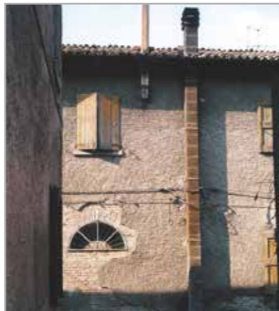
Fig. 6.1 - Каменное здание, подверженное подъему влаги
